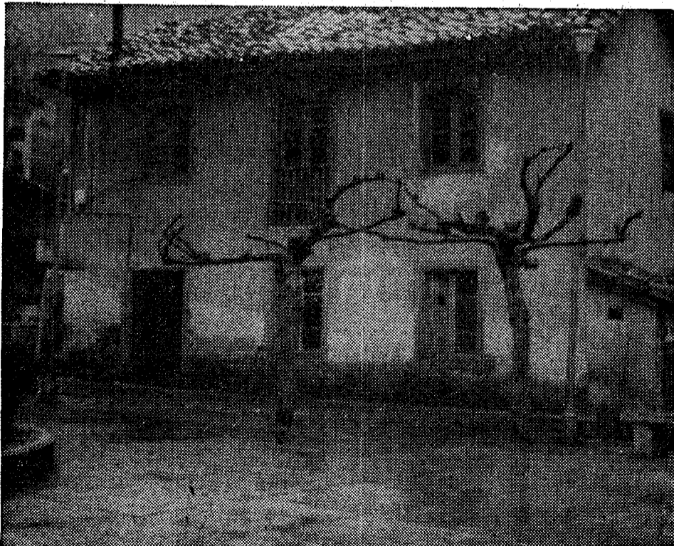
Un consultorio de la Seguridad Social, instalado en un edificio declarado en ruinas por el Ayuntamiento.
