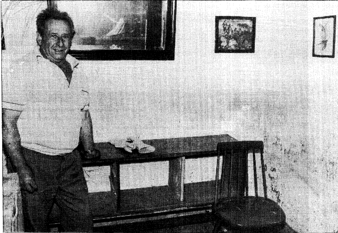
Ramón González muestra la marca dejada por el agua en el muro de su casa que alcanza el metro y medio.
