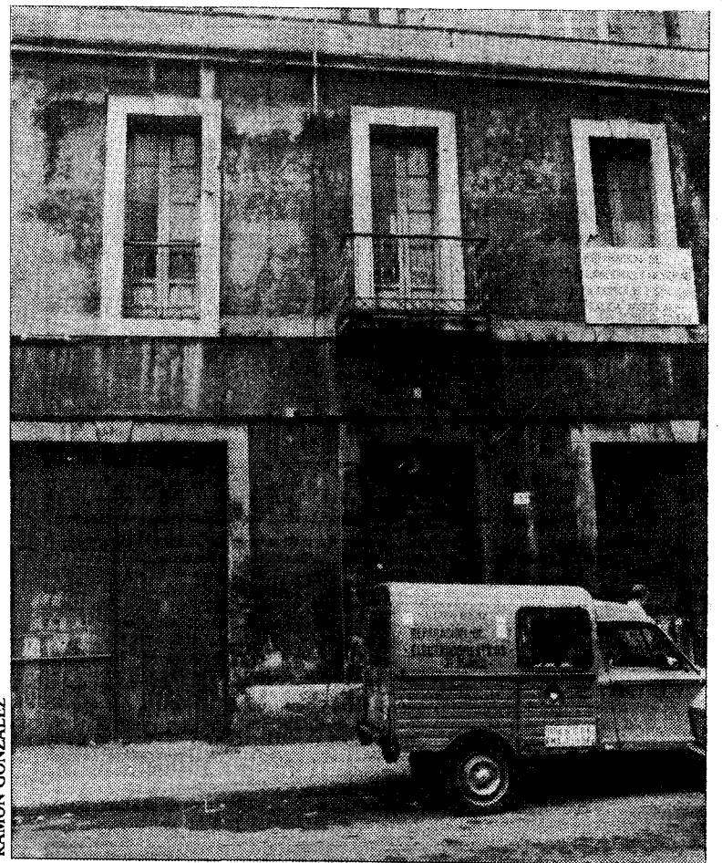
La parte trasera de este edificio se derrumbó, pese a lo cual sus ocupantes consiguieron abandonarlo.
