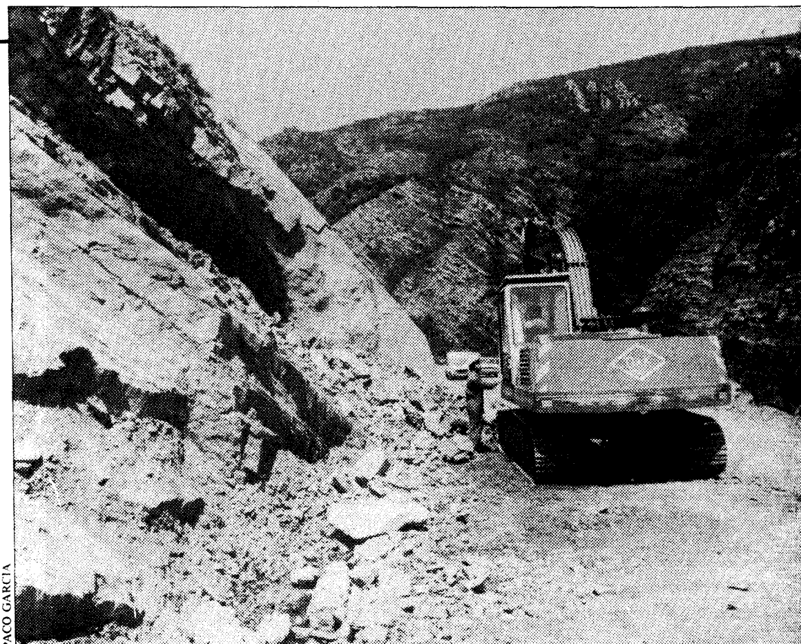
Un aspecto de las obras del corredor del Narcea en el tramo que actualmente está en obras.
