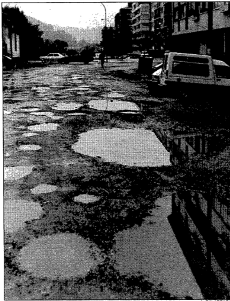
La avenida Principal se encuentra completamente deteriorada.
